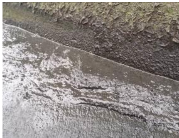
写真 2. 7 汚泥堆積状況（近景）
