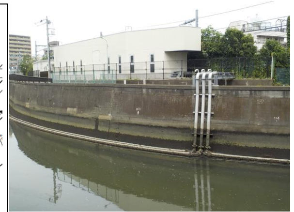
写真 2.1 高濃度酸素水浄化施設全景
