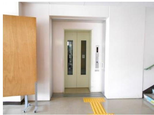
移動円滑化(エレベーター)
