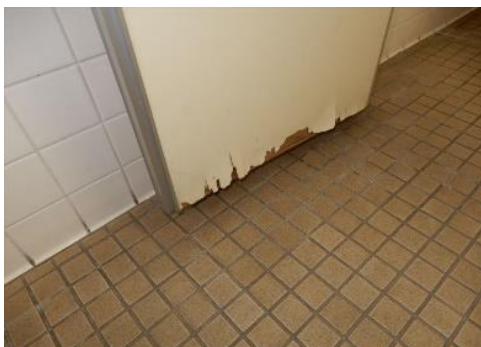
トイレブース下端の劣化
