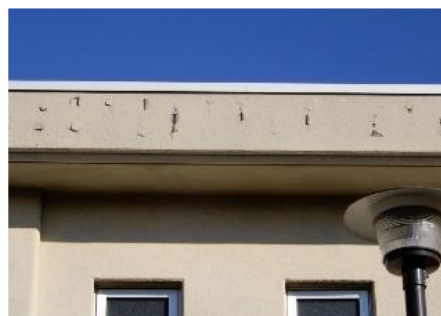
広範囲にひび割れ、爆裂が発生
