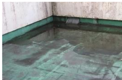
全体的に劣化が顕著で雨漏りが発生
