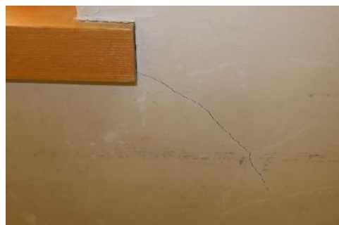
内壁のひび割れが発生している
