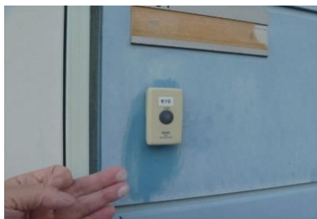
外壁パネルの退色、チョーキング
