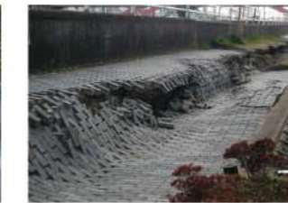
段差(段のようになっているところ)ができた境川護岸(洪水から川のほとりを守るつくりもの)
