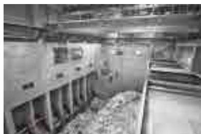
ごみクレーン・ごみバンカ
