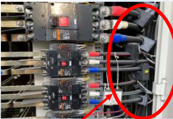
配電盤に電力計測器をたくさん付けています。
