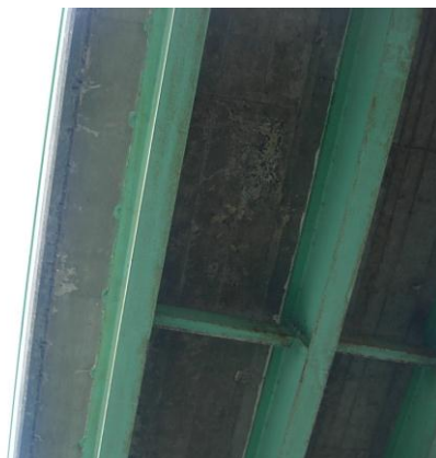
床版のひびわれ状況
