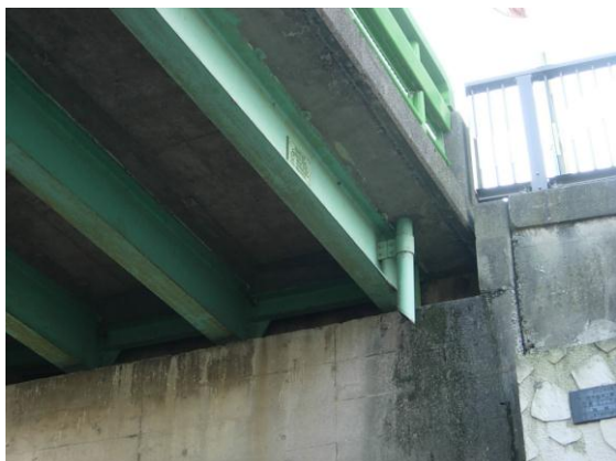
主桁の腐食状況
