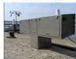
浸水しない高さにある電気供給施設 ※1
